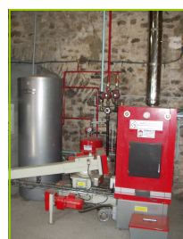
Chaudières individuelles ou collectives
